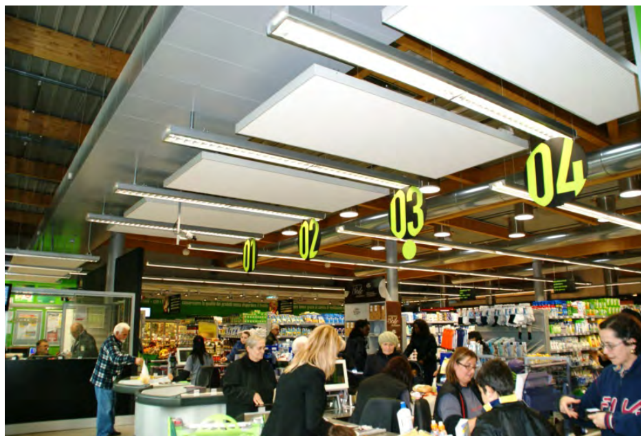
Figura 8 – Pannelli radianti a soffitto sulla zona casse, funzionanti in riscaldamento e raffrescamento.
